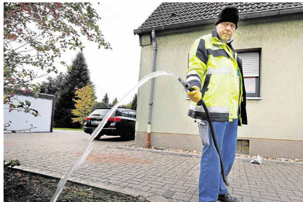
Monteur Gerhard Petersen entdeckte das Leck in der Wasserleitung an der Unteren Erlentiefenstraße. FOTO: MILK
