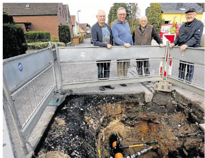
Durch ein Leck in einer Wasserleitung ist eine Gasleitung stark beschädigt worden. Durch das eingedrungene Wasser sind an die 500 Haushalte in Overberge und Rünthe betroffen. Gerd Brackelmann, Rolf Klar, Kurt Wolf und Walter Kulok (v.l.n.r.) sind Anwohner der Unteren Erlentiefenstraße und begutachten das reparierte Rohr. FOTO: MILK
